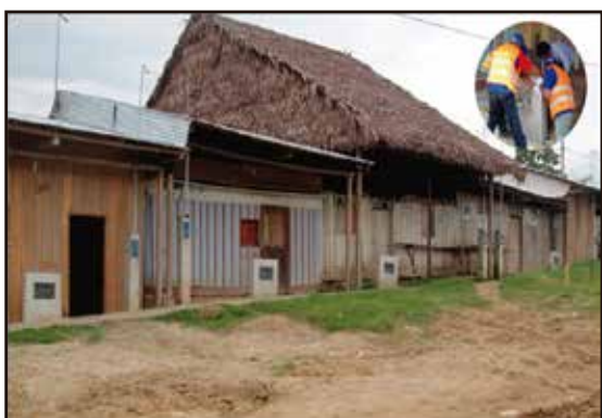
Medidores en muretes
