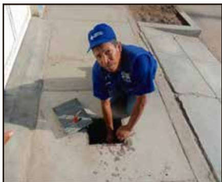
Revisión de medidor
