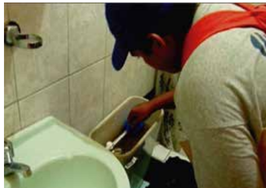
Inspección de fuga de agua en baño
