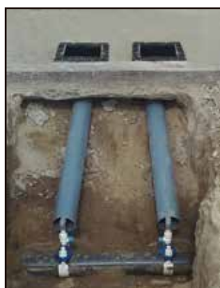
Conexiones de agua con tubería de abastecimiento enfundadas
